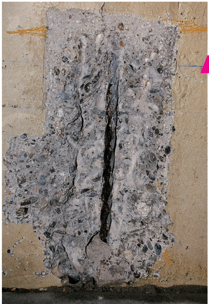
Das Bewehrungsseisen ist auf der Risseite korrodiert.
