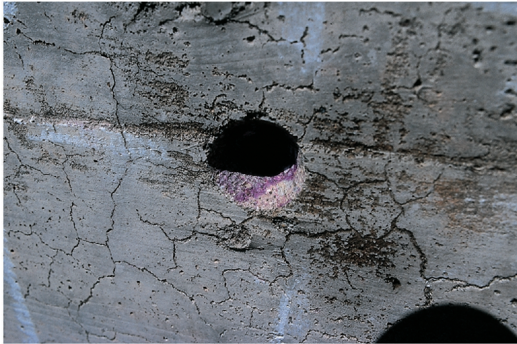
Rissursache: ungenügende Nachbehandlung.
