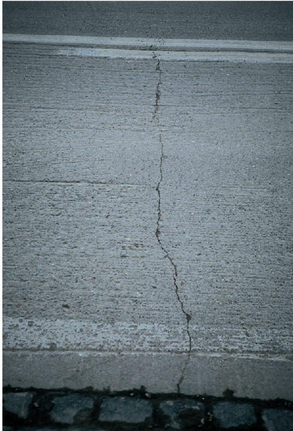
Durchgehender Riss in mehr als 50 Jahre alter Betonstrasse.
