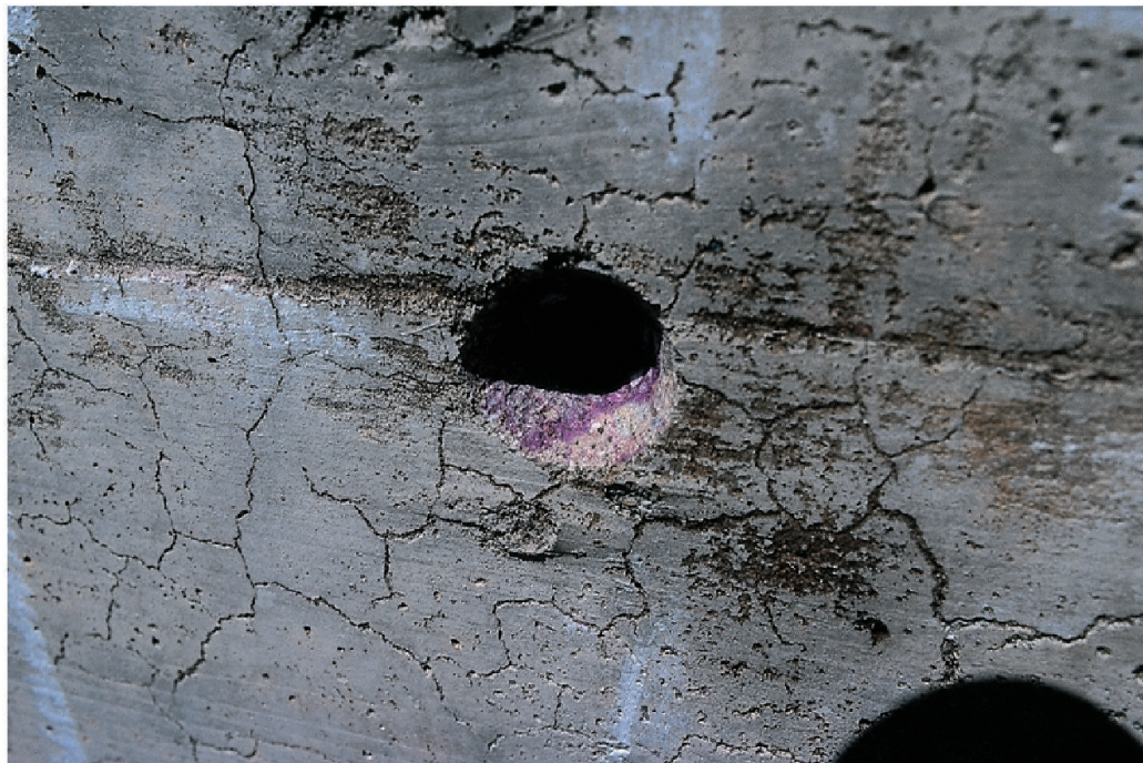
Rissursache: ungenügende Nachbehandlung.
