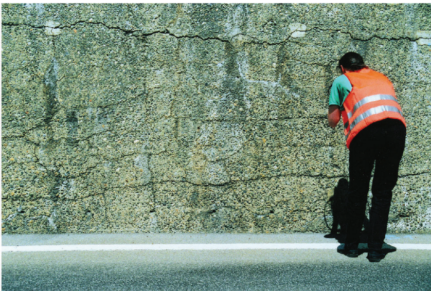
Abb. 3 AAR-Schäden in unbewehrter Stützmauer.
