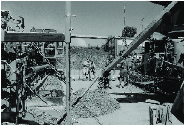
Abb. 4 Über ein Förderband, das über dem Unterbeton-Gleitschalungsfertiger montiert ist, wird der Beton für den Oberbeton-Gleitschalungsfertiger (links) antransportiert.
