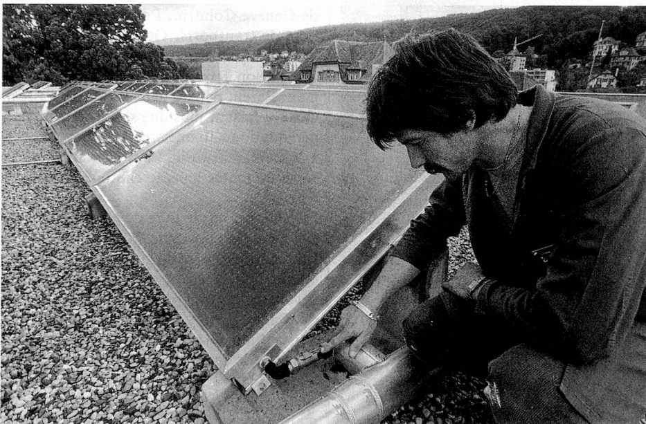
Capteurs solaires placés sur un toit pour la préparation d'eau chaude dans un foyer pour personnes âgées de Neuchâtel. (Photo: Keystone)
