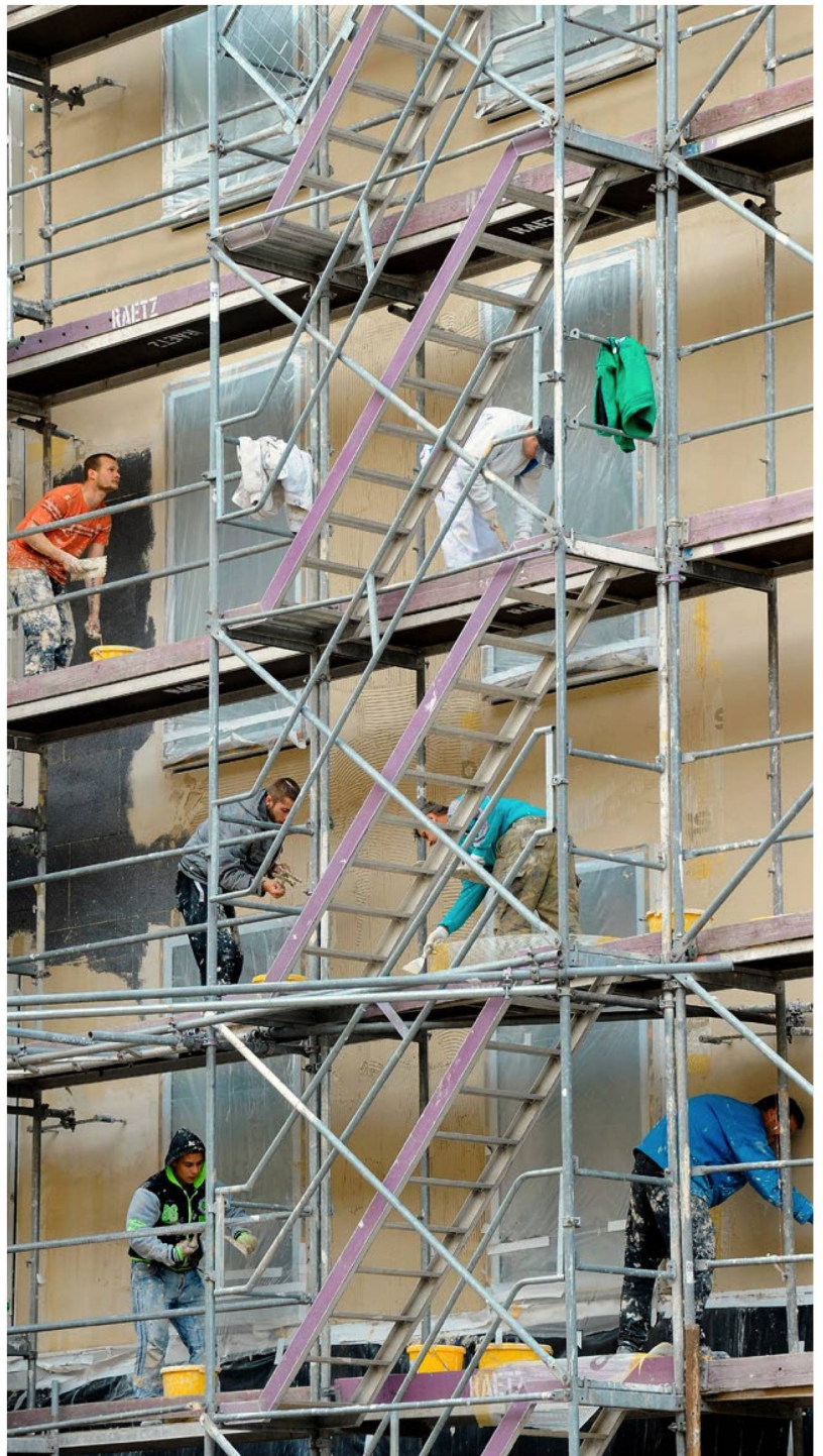
El acuerdo marco, tal como se propone, facilitaría a las empresas extranjeras ejecutar contratos en Suiza, por ejemplo, en la construcción. Esto es motivo de gran preocupación para los sindicatos, porque pondría en peligro el nivel actual de los salarios. Fotografía Keystone
