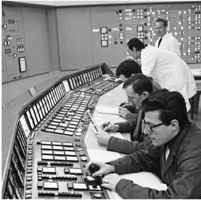
En la sala de control, un año antes de la avería (1967)
