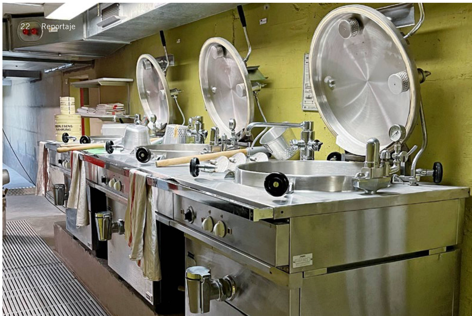
Aunque la cocina del búnker parece enorme, en caso de emergencia las comidas calientes estarían reservadas al personal directivo. Foto Keystone
