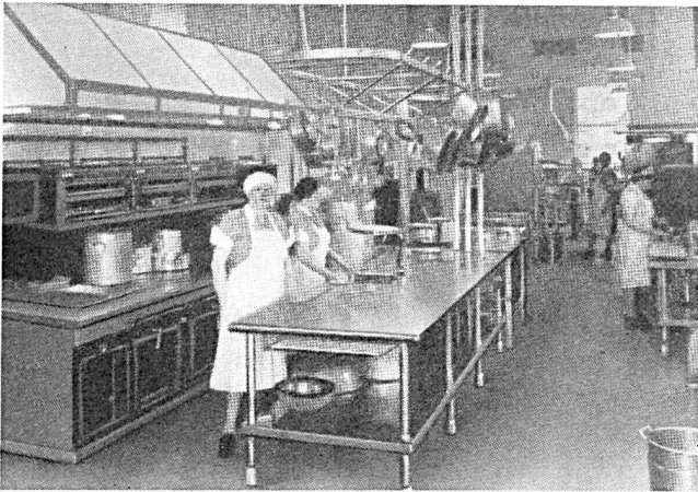
Fig. 22a. Cuisines du «Long Lines Building» à New-York
