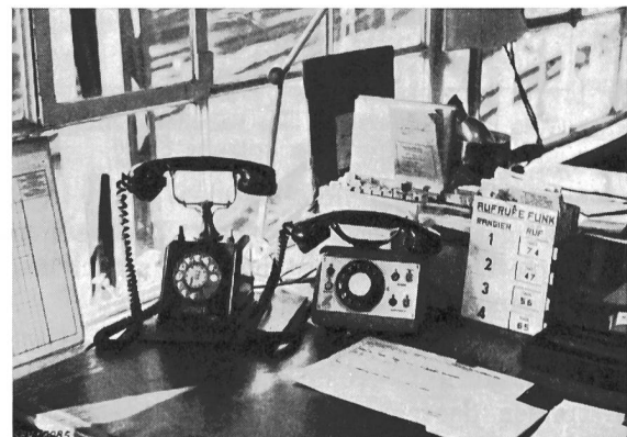
Fig. 5. Sprechstelle der Rangierfunkanlage auf dem Tisch des Aufsichtsbeamten im Hauptstellwerk. Sprechstelle mit Betriebsanzeigelämpchen, Nummernscheibe und Fernschalter mit Kontrolllampen für Sendevorheizung und Empfänger
