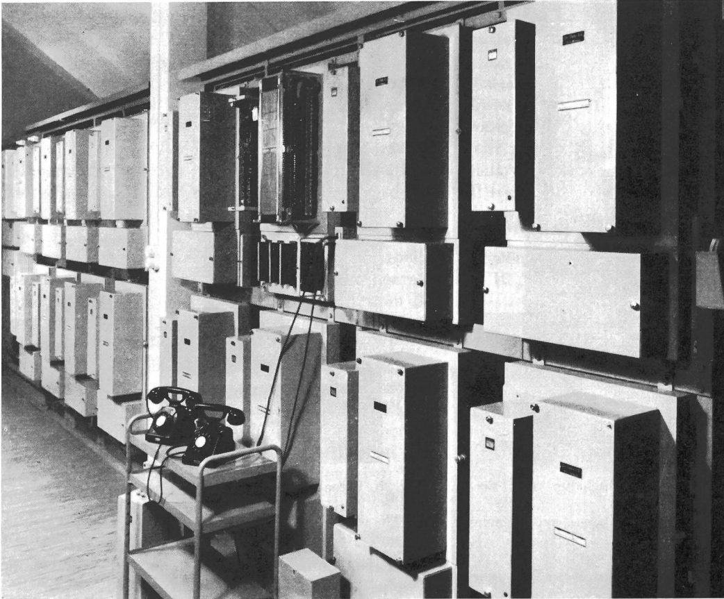
Fig. 5 Gestellreihe mit Leitungsdurchschaltern in der Telephonzentrale Basel Rangée de bâtis pour connecteurs de lignes dans le central téléphonique de Bâle
