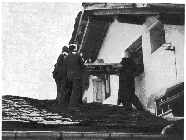
Fig. 6. Die je etwa 300 Kilogramm wiegenden Automatengestelle werden über ein Steinplattendach und durch das kleine Zentralenfenster an ihren Standort gebracht
