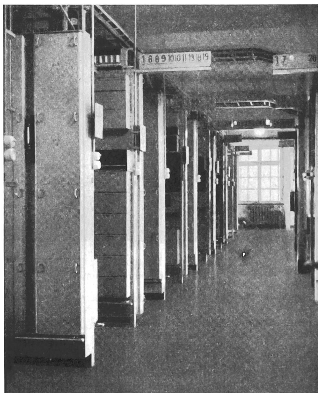
Fig. 8. Wählersaal Burgdorf Salle de sélecteurs Berthoud
