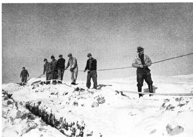
Fig. 10. Pose de câble dans la neige. Le câble coaxial est tiré sur des galets
