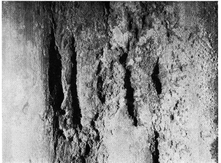
Fig. 6. Gleiches Kabel wie Figur 4. Korrosionsfurchen parallel zur Kabelachse (Vergrößerung 6×) Même câble qu'à la figure 4. Sillons de corrosion parallèles à l'axe du câble. (Grossi 6 fois)
