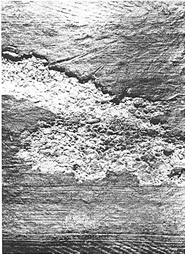
Fig. 1. Korrodierte Stelle auf der Oberfläche des bei Wilchingen blank eingegrabenen Bleimantels. Vergrößerung: 5 × Endroit corrodé à la surface de la gaine de plomb du câble nu enfoui près de Wilchingen. Grossi 5 ×
