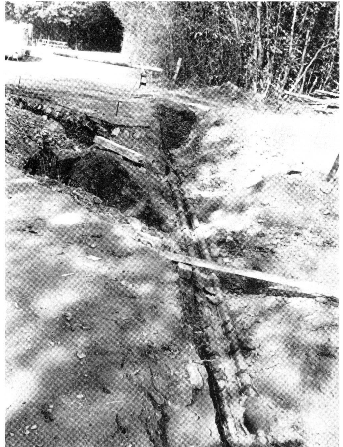
Fig. 4. Die Schadenstelle nach der Behebung der Kabelstörung. Vorne rechts und hinten links die Kabelschutz-muffen
