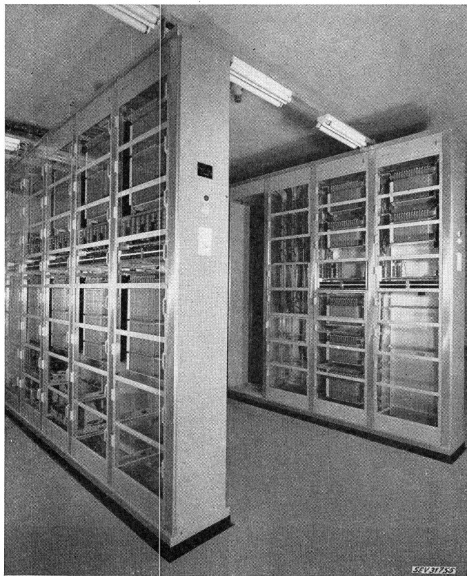
Fig. 9. Vue partielle d'un central crossbar. Au premier plan, des bâtis de sélecteurs d'abonnés; à l'arrière-plan, des bâtis de sélecteurs de connexion
