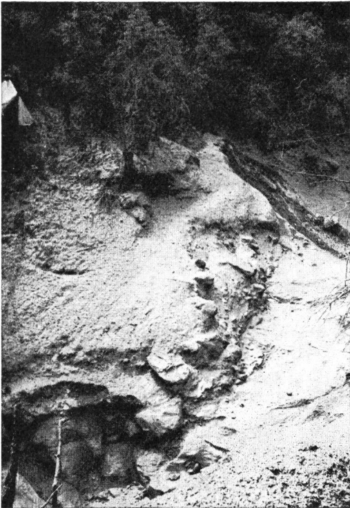
Fig. 2. Erosion à l'emplacement des câbles téléphoniques
