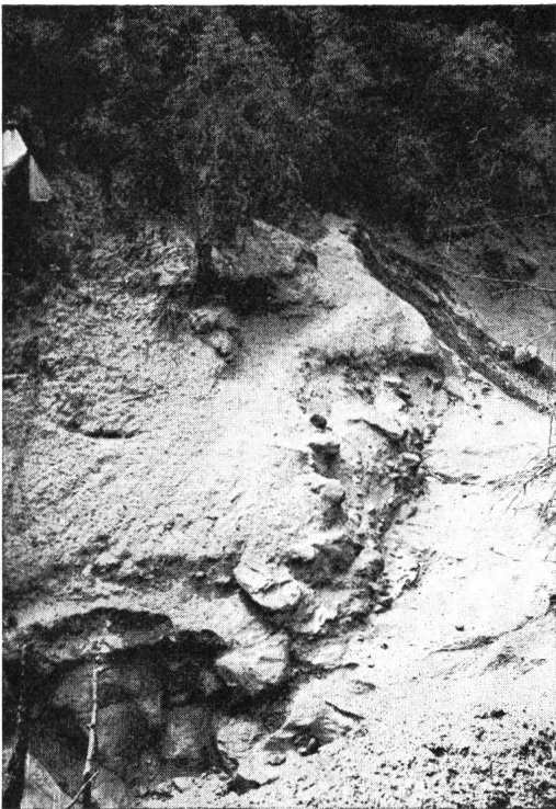
Fig. 2. Erosion à l'emplacement des câbles téléphoniques
