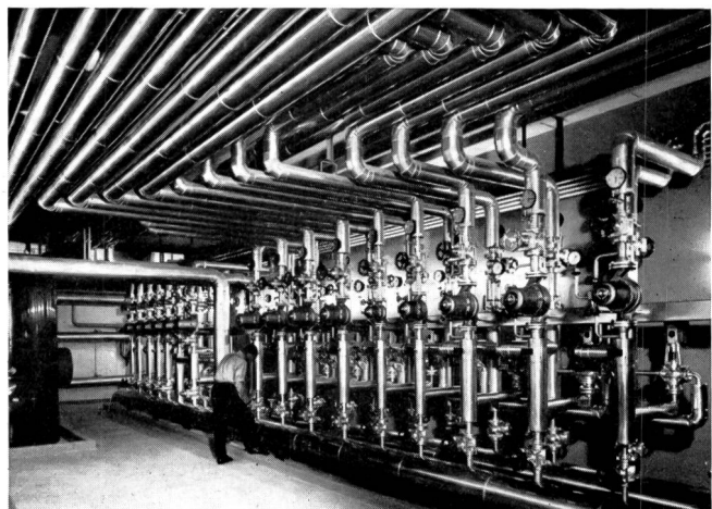
Fig. 3 Heizverteiler mit 16 vollautomatisch regulierenden Heizgruppen
