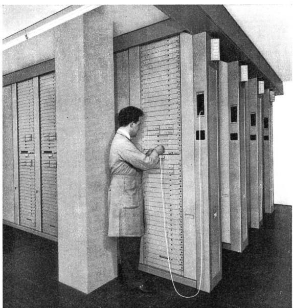
Fig. 69 Haustelephonzentrale nach dem System ESK N 62 in der Schanzenpost Bern Central téléphonique du système ESK N 62 à la Schanzenpost à Berne
