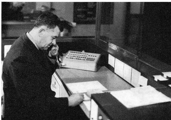
Fig. 75 Nacht-Vermittlerstelle (Pikettstation) in der Portierloge Poste de commutation de nuit (poste de piquet) installé dans la loge du portier
