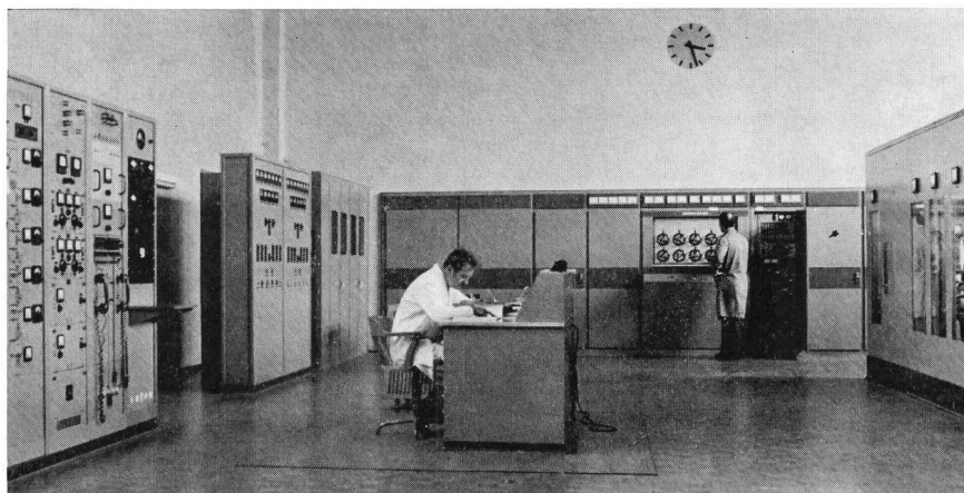
Salle d'émission des ondes moyennes à l'émetteur national de Sottens. De gauche à droite, bâti de contrôle et de mesure, tableau de courant fort et redresseur à haute tension, face du nouvel émetteur à ondes moyennes de 500 kW (à l'arrière-plan), partie de l'émetteur de réserve de 2 \times 100 kW. Au milieu, pupitre de commande de l'émetteur de réserve
