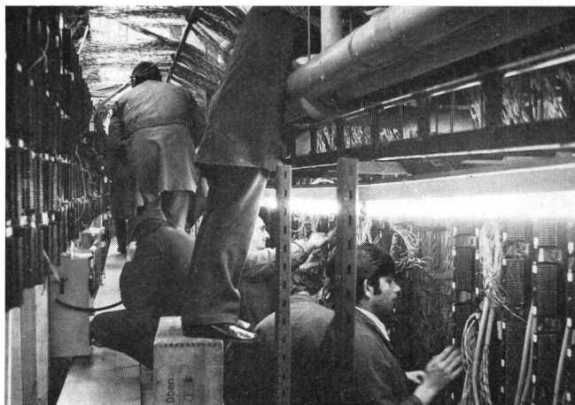
Fig. 14 Überführungs- und Kablierungsarbeiten am provisorischen Hauptverteiler Etablissement des renvois et du câblage au répartiteur principal provisoire
