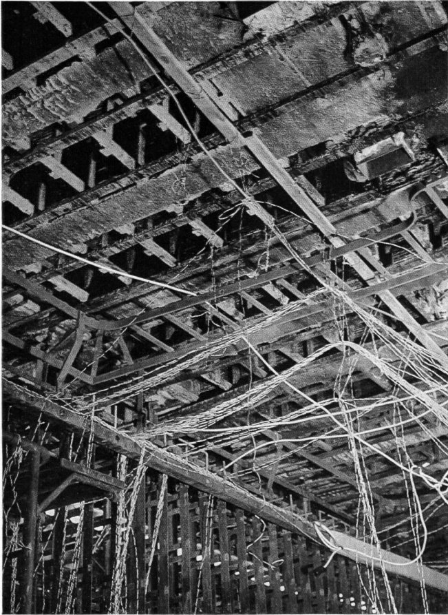
Fig. 3 Brand- und Korrosionsschäden im Hauptverteilterraum Dégâts causés à la salle du répartiteur principal par le feu et la corrosion
