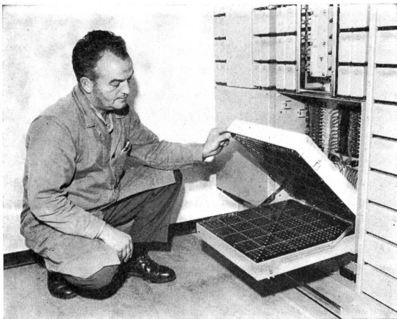
Fig. 11 Anordnung der Abgleichsätze in der Kabelkopfbucht auf der Empfangsseite Disposition des équipements d'équilibrage dans le bâti des têtes de câbles, côté réception
