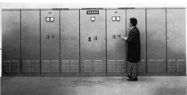
Fig. 10 Gleichstromanlage 48 V, Typ 600 A zur Speisung von Richtstrahl- anlagen
