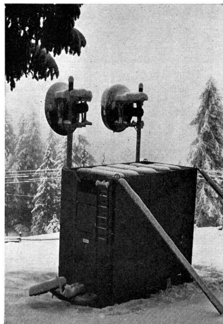
Fig. 13 Fahrbare Richtstrahlkabine PTT (Fahrgestell entfernt und verankert) Cabine à faisceaux hertziens mobile système PTT (châssis enlevé et cabine amarrée)
