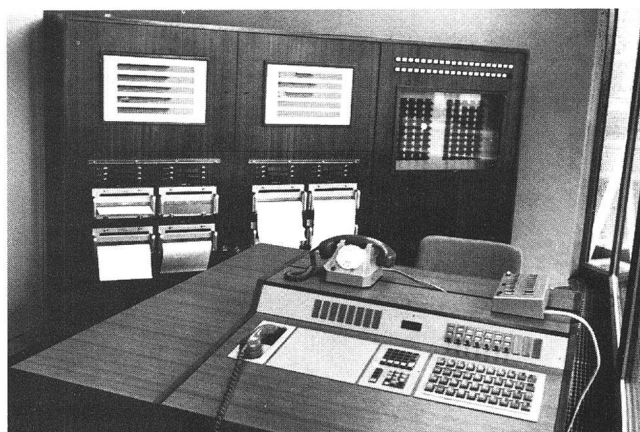
Fig. 2 Local des téléphonistes. A l'arrière-plan, les 4 groupes de 2 imprimeurs et les tableaux de répartition des internes
