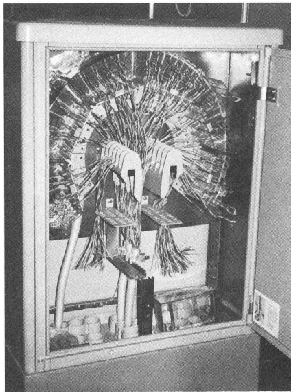
Fig. 4 Kabelverteilkasten mit kreisförmiger Aufteilung der Adern, die somit alle gleich lang vorbereitet und sehr einfach aufgeschaltet werden können (Peyer)
