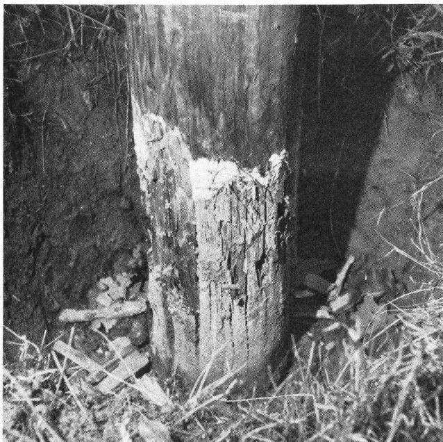
Fig. 7 Poteau partiellement détruit par le champignon dans le jardin de poteaux – Palo parzialmente distrutto dai funghi in terreno sperimentale
