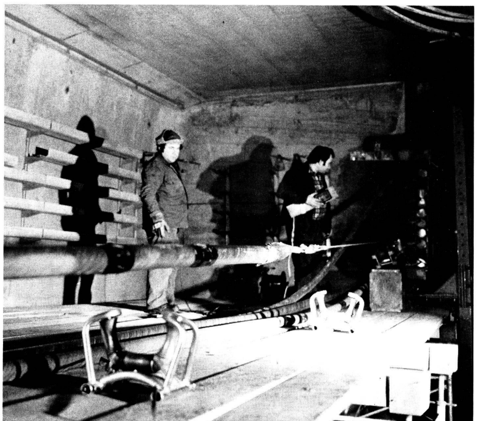
Fig. 4 Ein Koaxialkabel kurz vor dem Eintritt in den Asbestzement-Rohrzug mit 100 mm Innendurchmesser. Kabeldurchmesser: 76,3 mm; Kabelgewicht: 8,5 kg/m. Für die telefonische Verständigung war wegen des Baustellenlärms die Verwendung von Kopfsprechgarnituren unumgänglich — Cavo coassiale pronto per l'introduzione nel tubo di cemento-amianto del diametro interno di 100 mm. Diametro del cavo: 76,3 mm; peso: 8,5 kg/m. A causa dei rumori di cantiere è stato necessario fare uso di cuffie per le comunicazioni telefoniche di lavoro
