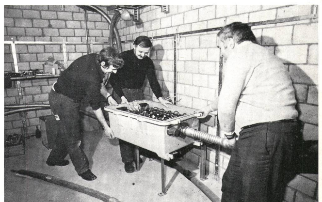
Fig. 16 Einfügen eines Zwischenverstärkers
