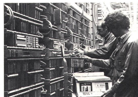
Testarbeiten an den mikrocomputer-gesteuerten elektronischen Multiregistern
