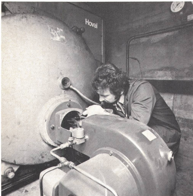
Il y a lieu d'antiparasiter tant les installations industrielles...
