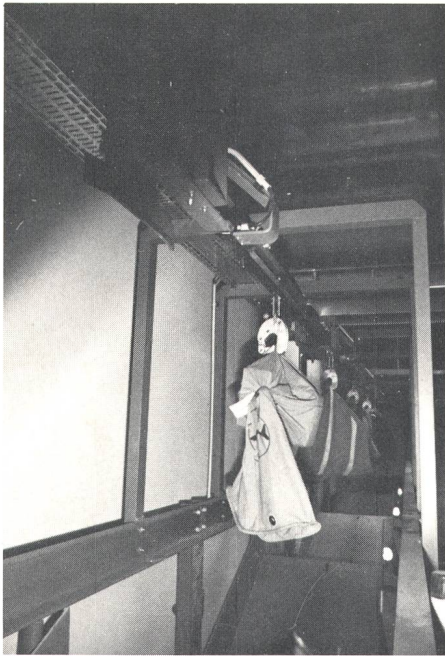
Fig. 6 Vue du transporteur à chaîne avec des pinces à sacs chargées passant au-dessus des entrées des glissières de stockage
