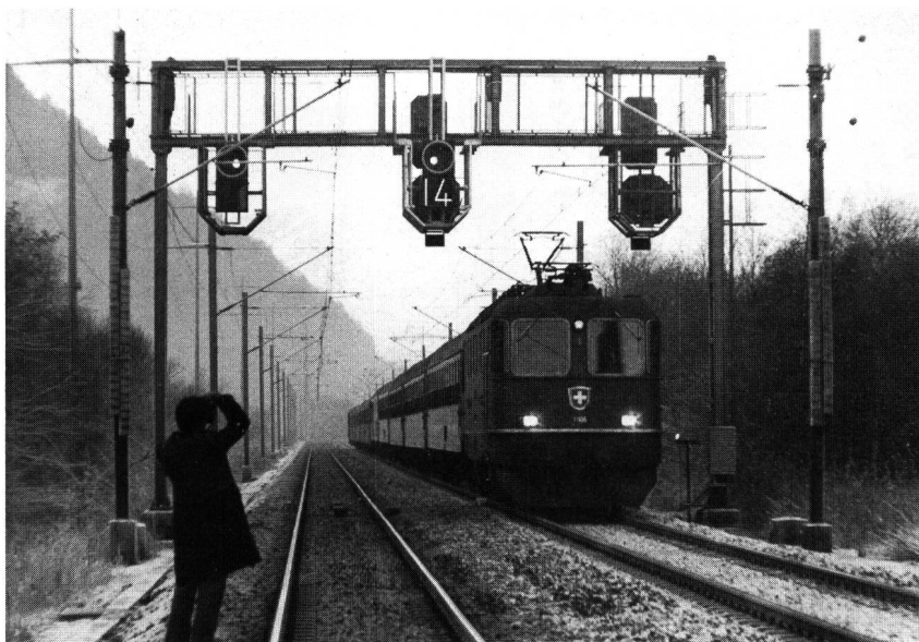
Fig. 1 Signale des neuen Systems auf der Strecke Leuk-Visp, die mit 160 km/h zu fahren erlauben
