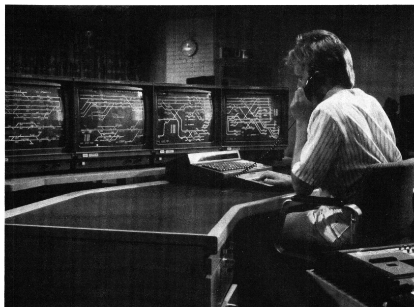
Fig. 6 Bedienteil und Anzeige des ersten Rechner-Stellwerkes der Welt in Göteborg
