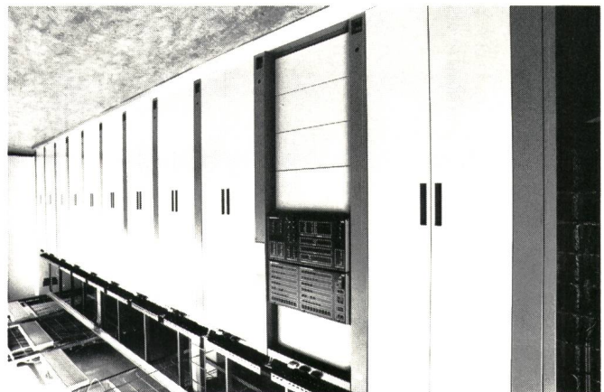
Fig. 4 PC-85-Anschlusszentrale, wird auf PC 88 mit systemintegrierter Taxdatenregistrierung ausgebaut – Central de raccordement PC 85. Sera modifié en PC 88 avec dispositif d'enregistrement des données de taxation intégré au système
