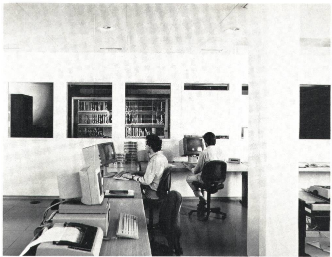
Fig. 10 Betriebsraum Hauptzentrale Luzern-Floraweg – Salle d'exploitation et de maintenance du central principal de Lucerne-Floraweg
