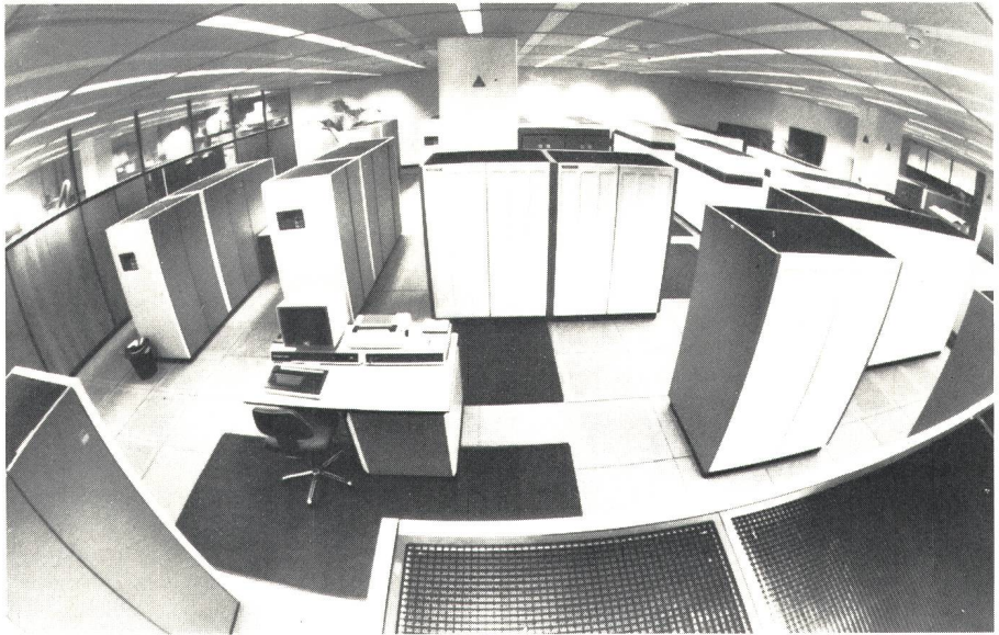
Teilansicht des Produktions-Rechenzentrums. Zurzeit sind 6 Grossrechner installiert. Die auf Disk abgespeicherten Daten würden 670 000 Bundesordner füllen
