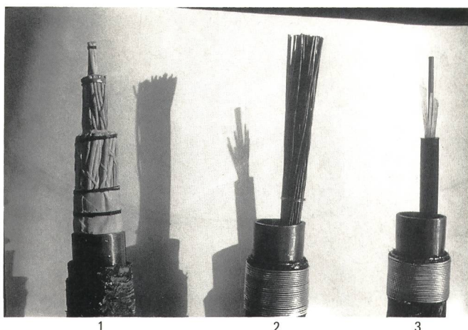
Fig. 1 Darstellung der Auswirkung des Ausbrennvorganges 1 DM-Papierlufttraumkabel 2 Ausgebranntes Kupferbündel 3 Eingezogenes Glasfaserkabel
