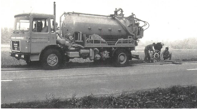
Fig. 11 Fahrzeug mit Wassertank und Einrichtung zur Erzeugung des Hochdruckes
