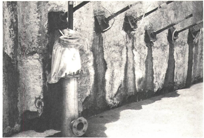
Fig. 14 Ankerköpfe mit Undichtigkeiten, vorne ein Grundwasserabsenschacht
