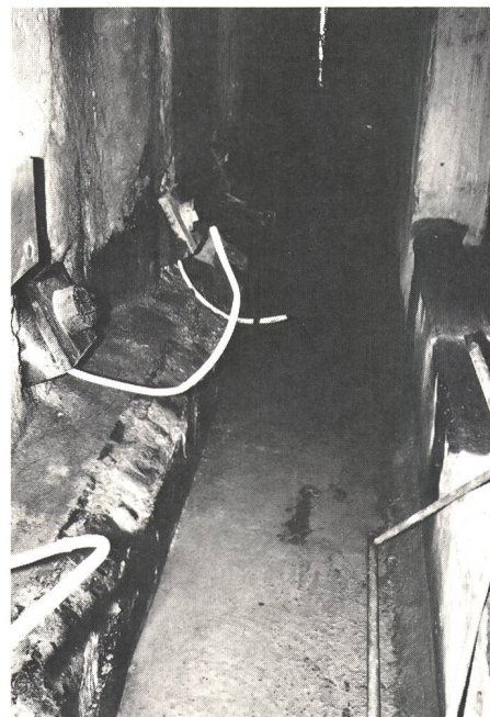
Fig. 15 Blick in den Kontrollschacht. Gut sichtbar sind die Ankerköpfe, der Betonsockel mit Abdichtung und die vertikale Schutzschicht aus einer Gummigranulatmatte
