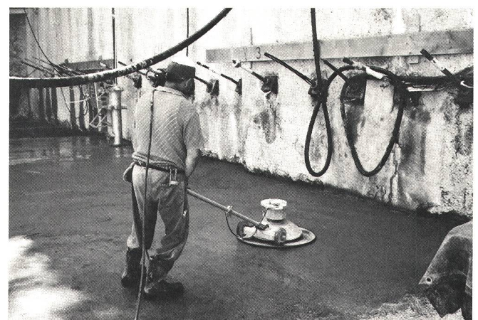
Fig. 12 Zur Aufnahme der Abdichtung muss die Oberfläche der unteren Betonplatte geschliffen werden
