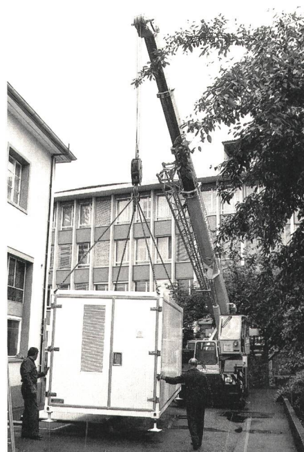
Fig. 4 Aufstellung des Containers mittels eines Krans – Mise en place du conteneur au moyen d'une grue
