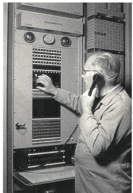
Dieser «Monitor» diente der Belegungsbeobachtung sowie der Prüfung und Messung der interzentralen Verbindungsleitungen
