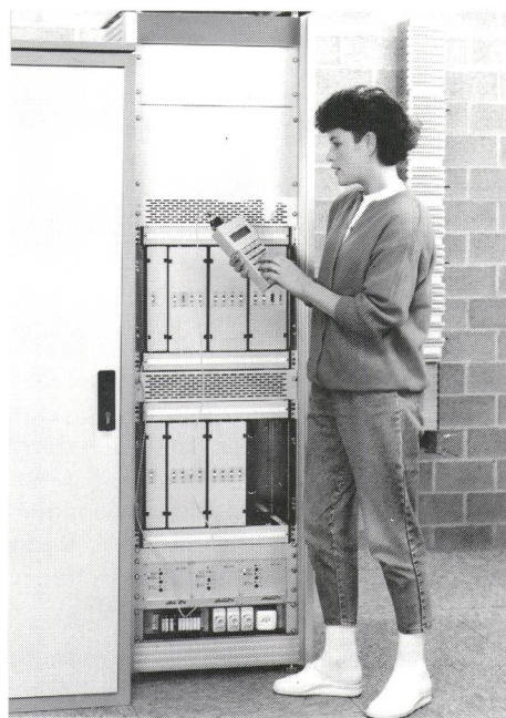
Fig. 2 Kundenseitiger Einbau in 19-Zoll-Gestell
