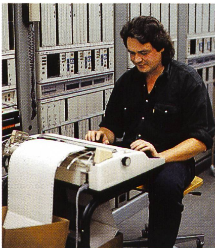
Peter Tuynder, Fernmeldespezialist, prüft in der Zentrale Steffisburg Daten kurz vor dem Umschaltzeitpunkt.
