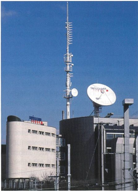
Bild 2. Die baulichen und technischen Anlagen beim Fernzentrum Grosspeter eignen sich ideal für die Beherbergung von Gastprojekten auf dem Gebiet der Breitband-Telekommunikation.
