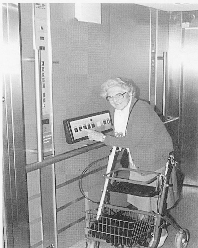
Beispiel einer gelungenen Liftsanierung in einem Blinden- und Sehbehindertenheim in Zürich: Zusätzliches Behindertentableau, doppelte Stockwerkerkennung (oben im Bild der Lautsprecher), erhabene Taster mit eingravierten Normalbuchstaben und Braille-Schrift, gut gekennzeichnetes Nottelefon.
