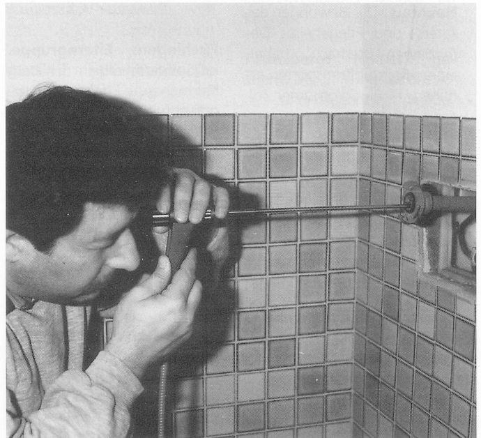
Sorgfältig überprüft der LT-Spezialist die Sanierungsarbeit mit dem Endoskop, denn nur sorgfältige Arbeit gewährleistet die Qualitätsgarantie nach SIA-Norm 118.
