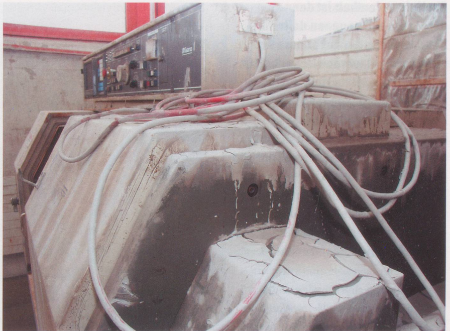
Maschinen voller Schlammrückstände in den zerstörten Werkstätten.
