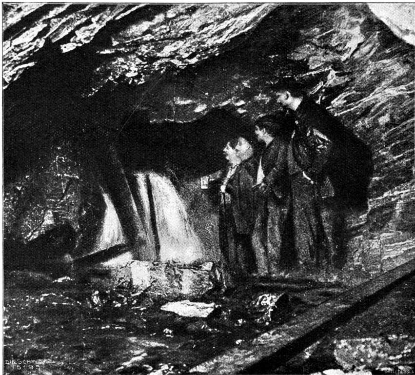
Der Durchschlag des Simplontunnels (24. 11. 1905). Die Durchschlagsöffnung, die den Süd- und den Nordstollen verbindet (Phot. Ferrario, Mailand).
