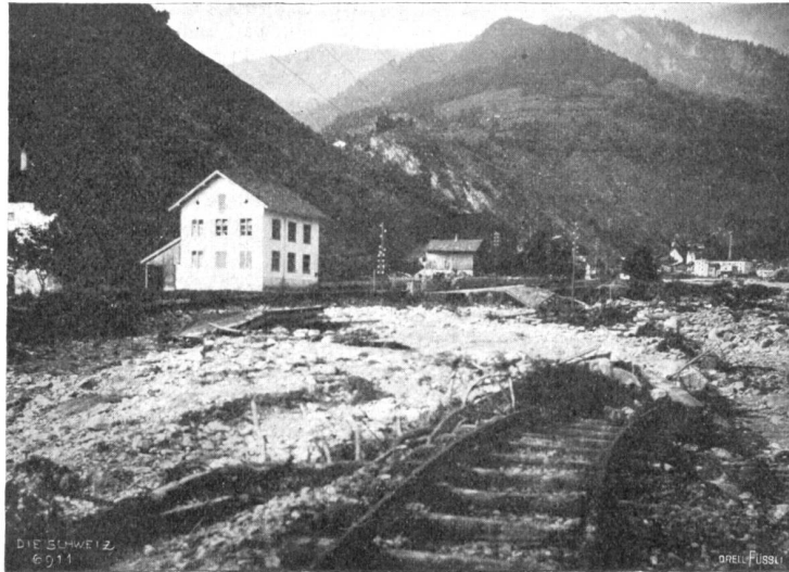
Zerstörte Bahnbrücke bei der katholischen Kirche in Pardisola. Im Hintergrund rechts Grüsch. Phot. P. Hüb, Malans.
