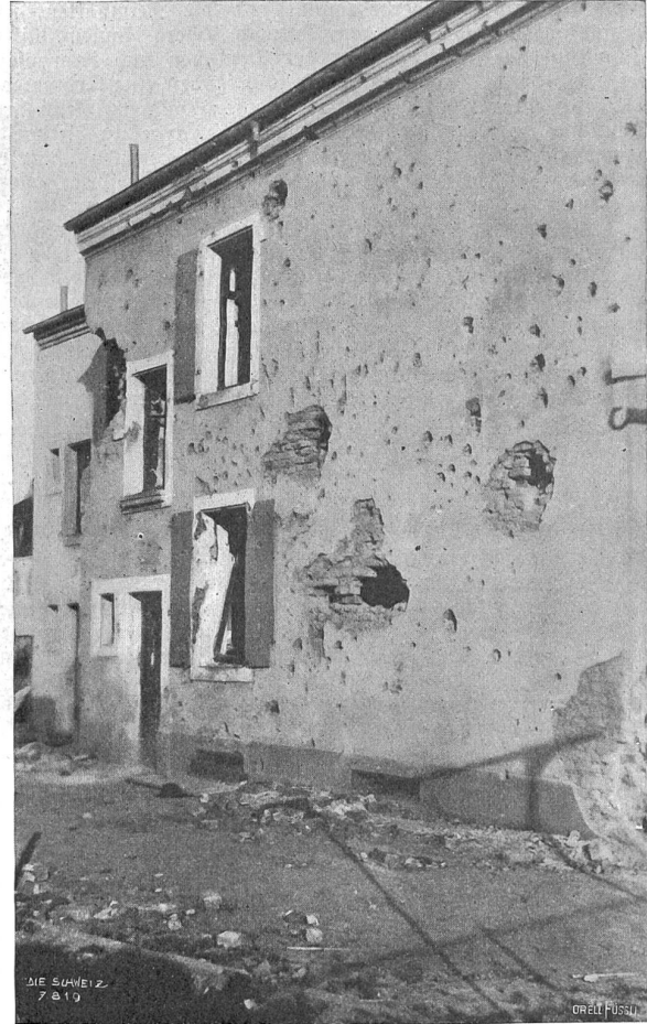
Durch Schrapnells und Flintenschüsse zerstörtes Haus in Illberg-Dornach (Elsass). Phot. Willy Schneider, Zürich.
